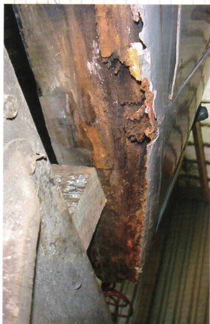
Panel under dør, højre side - der er råd både i plade og træ.
